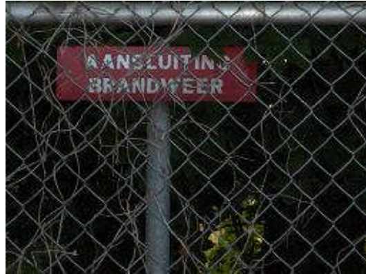
Foto 3b: aansluiting voor de brandweer
